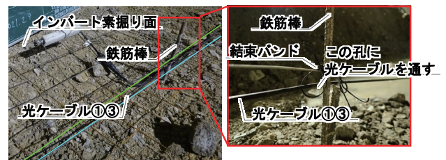
Photo 3 インバート吹付けコンクリートへの敷設 (Optical Fiber Cable Placed in Invert)
