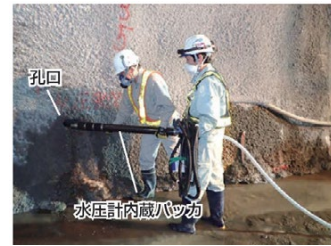
Photo 4 短尺パッカ挿入状況 (気高第一トンネル) (Insertion of Packer System at Kedaka Tunnel)
