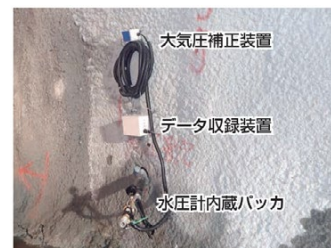
Photo 5 短尺スイリモによるモニタリング状況 (Monitoring of Water Pressure by Short Boring SWIReMo)
