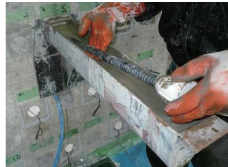
Photo 3 グラウト貯留槽による施工状況 (Construction using Grout Storage Tub)
